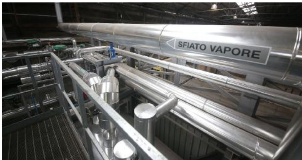
L'impianto per il recupero del calore attivato nel 2016 alla Ori Martin e collegato alla rete del teleriscaldamento
